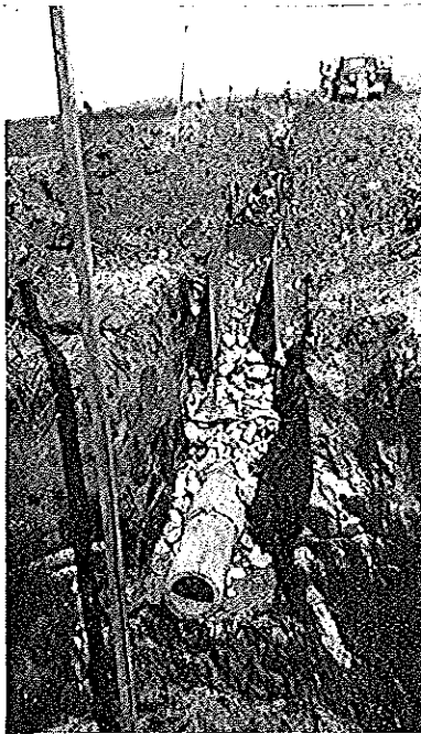
Drensør under rullebanene.
